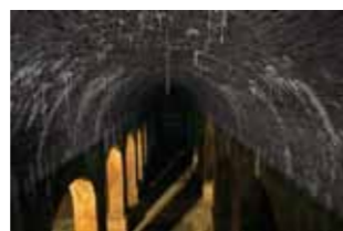
SARISTAU Depósito de agua de Roces I, Gijón
